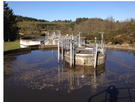
Traitement à la station d'épuration
